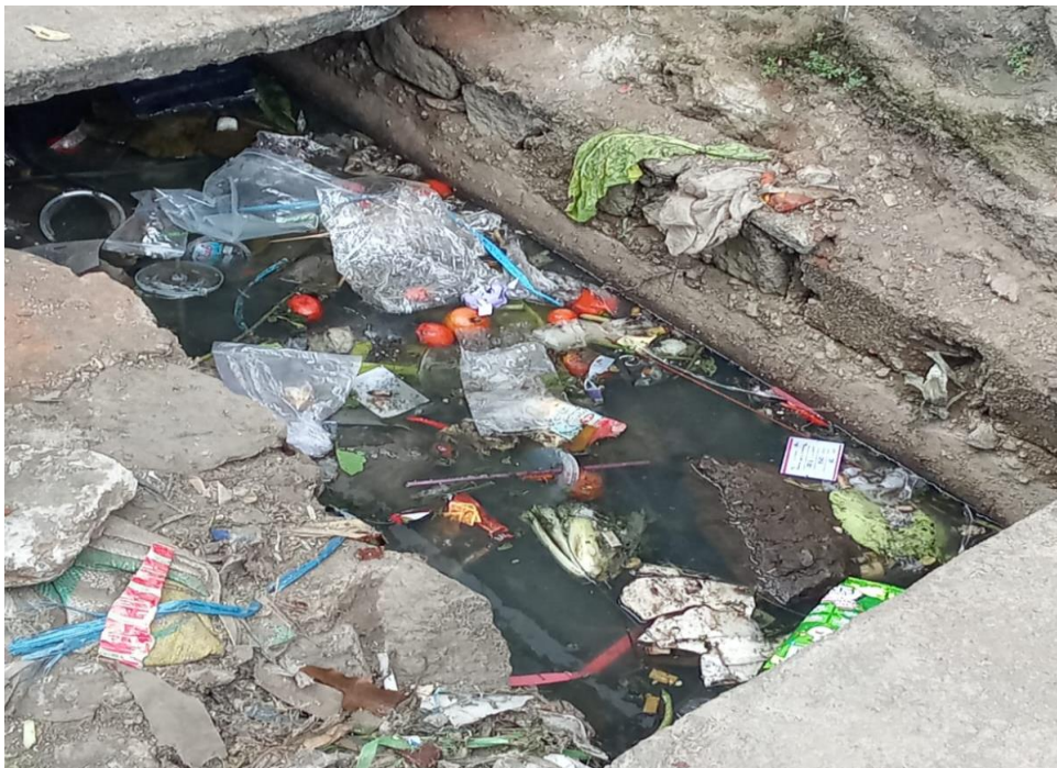
Gambar 3. Kondisi sampah berserakan pada selokan yang berada di dekat pasar.
