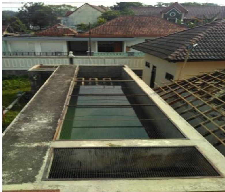
Gambar 12. Bak Sedimentasi pada WTP di RS Jiwa Grasia DIY
