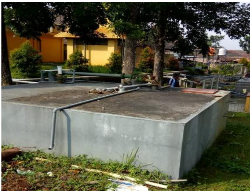
Gambar 14. Bak Groundtank Reservoir 2 pada WTP di RS Jiwa Grhasia DIY
