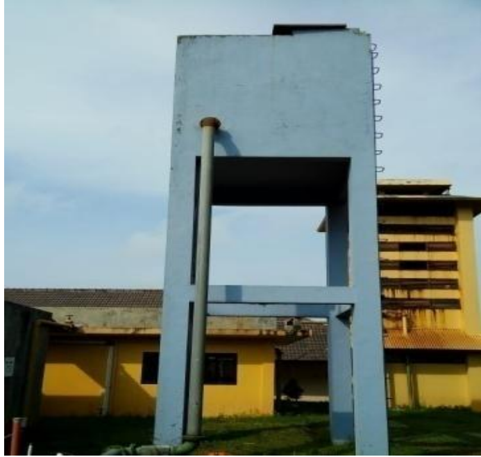
Gambar 15. Bak Tower Air pada WTP di RS Jiwa Grhasia DIY
