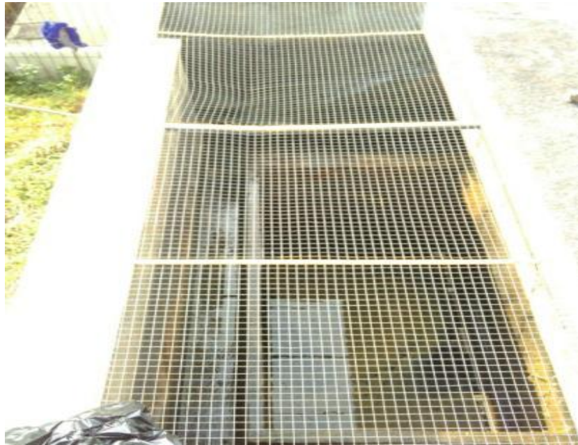
Gambar 13. Bak Filtrasi pada WTP di RS Jiwa Grhasia DIY
