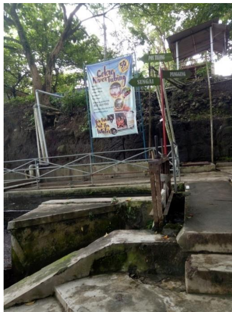
Gambar 2 Kondisi pipa untuk menaikkan air ke kolam renang
