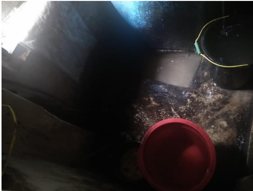
Keadaan sarana pembuangan air limbah yang tersumbat
