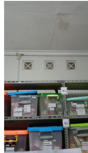
Gambar 18. Ventilasi ruang penyimpanan
